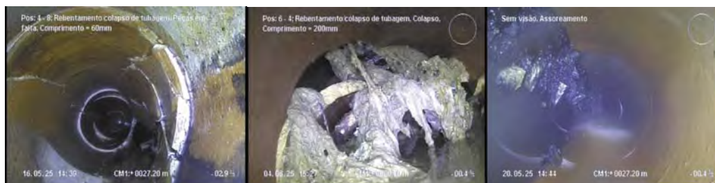
Anomalias nas infraestruturas identificadas com recurso a inspeção vídeo
